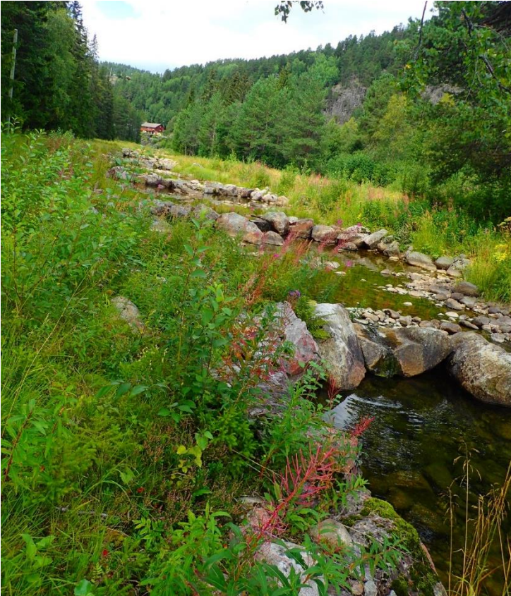
Figur 1-45 Terskler i østre elveløp mellom bru B1 Bruflot og bru B2 Østre Bora.
