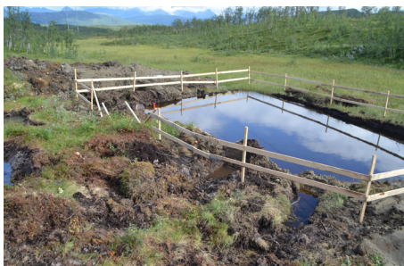
Figur 39: Etabler sedimentsjonsbasseng for håndtering av vann fra byggegrøp for mastepunkt. Bassenget fylles igjen etter bruk..
