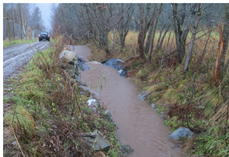
Figur 39: Eksempel der naturlig bekk er utnyttet ved å lage mindre demninger for å samle opp partikler fra vegbygging. Bassengene må tømmes regelmessig, og fjernes når avrenningen opphører.
