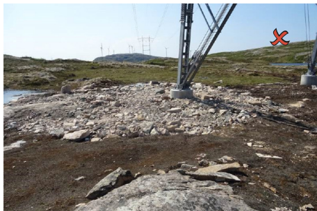
Figur 21: Sprengsteinsblokk skal ikke ligge igjenn på overflaten som på bildet, men brukes som fyllmasse eller graves ned.
