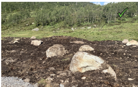
Figur 30: Natirstein som en del av tilbakefylling. Steinen er nedsenket i massene, slik at det fylles rundt basis.
