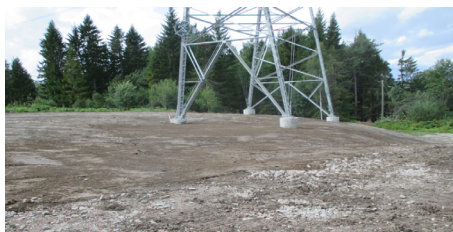
Figur 28: Mastepunkt som er tilbakeført som en stor glatt flate. Her burde flaten vært brutt opp ved å lagd forhøyninger og forsenkninger. I tillegg burde det vært plassert ut vegetasjonstuer for at naturlig veetasjon raskere kan reetableres.
