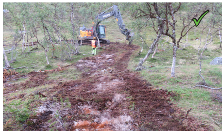
Figur 31: Ved uttransportering av maskiner og utstyr, skal kjørespor legges i gjenn og pusses. Gjennlagte spor skal ikke på nytt benyttes uten avklaring med Statnett
