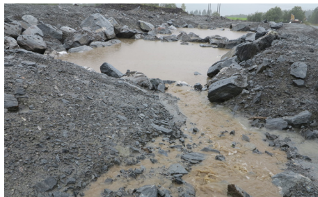
Figur 37: Eksempel på konstruert sedimentsjonsbasseng for avrenning fra stasjonstomt. Utløpet er neddykket slik at eventuelle oljerester legger seg på overflaten.
