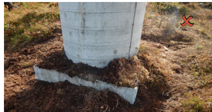
Figur 19: Ikke god overgang mellom stabbe og terreng. Massene oppå betongen vil tørke ut.
