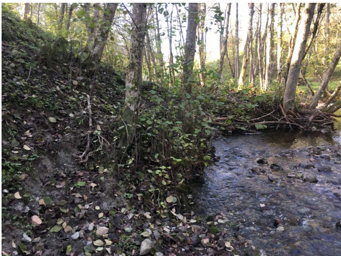
Figur 12: Trær i elveskråning viser tegn til sig, og det er ca. 1-1,5 m erosjonskant i innersving.
