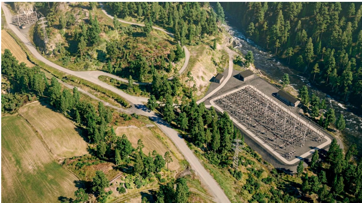
Figur 4 Illustrasjon av omsøkt tiltak (eks. ledninger). Nye Kaggefoss koblingsanlegg til høyre, eksisterende Kaggefoss transformatorstasjon oppe til venstre i bildet.
