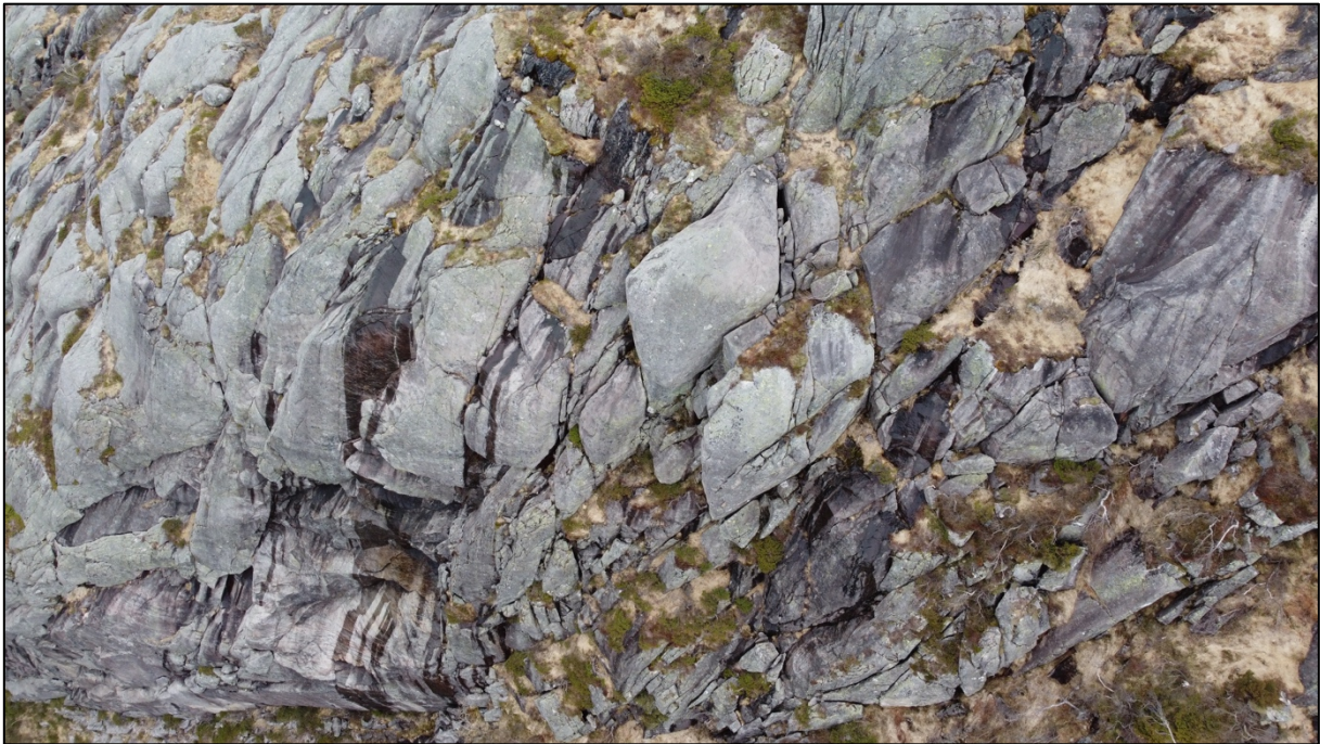
Figur 13: I den nordvestlige skråningen finnes det en rekke sprekkavgrensede bergblokker.
