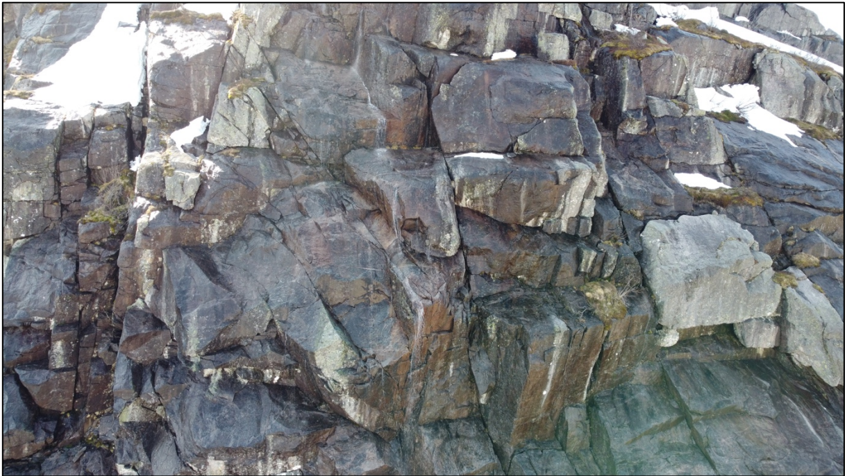
Figur 40: Bergblokker på opptil flere titalls m 3 er avløst av sprekker i skråningen i sørvest.
