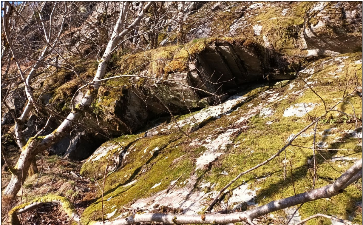
Figur 7: Fjellet i påverknadsområdet består av kvartsskifer og foliasjonsplana har fall mot nord. Dette er bra for totalstabiliteten, men danner skifrige overheng i fjellskrenten. Infopunkt 1.
