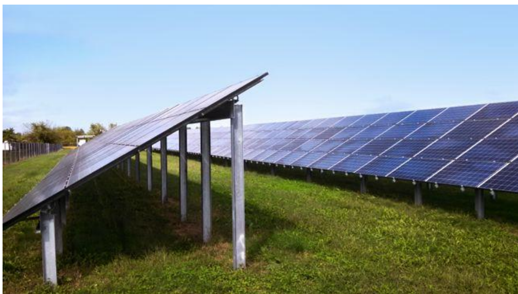
Figur 3-3: Eksempel på fast-vinkel installasjonsløsning (foto: Willowbrook Solar)
