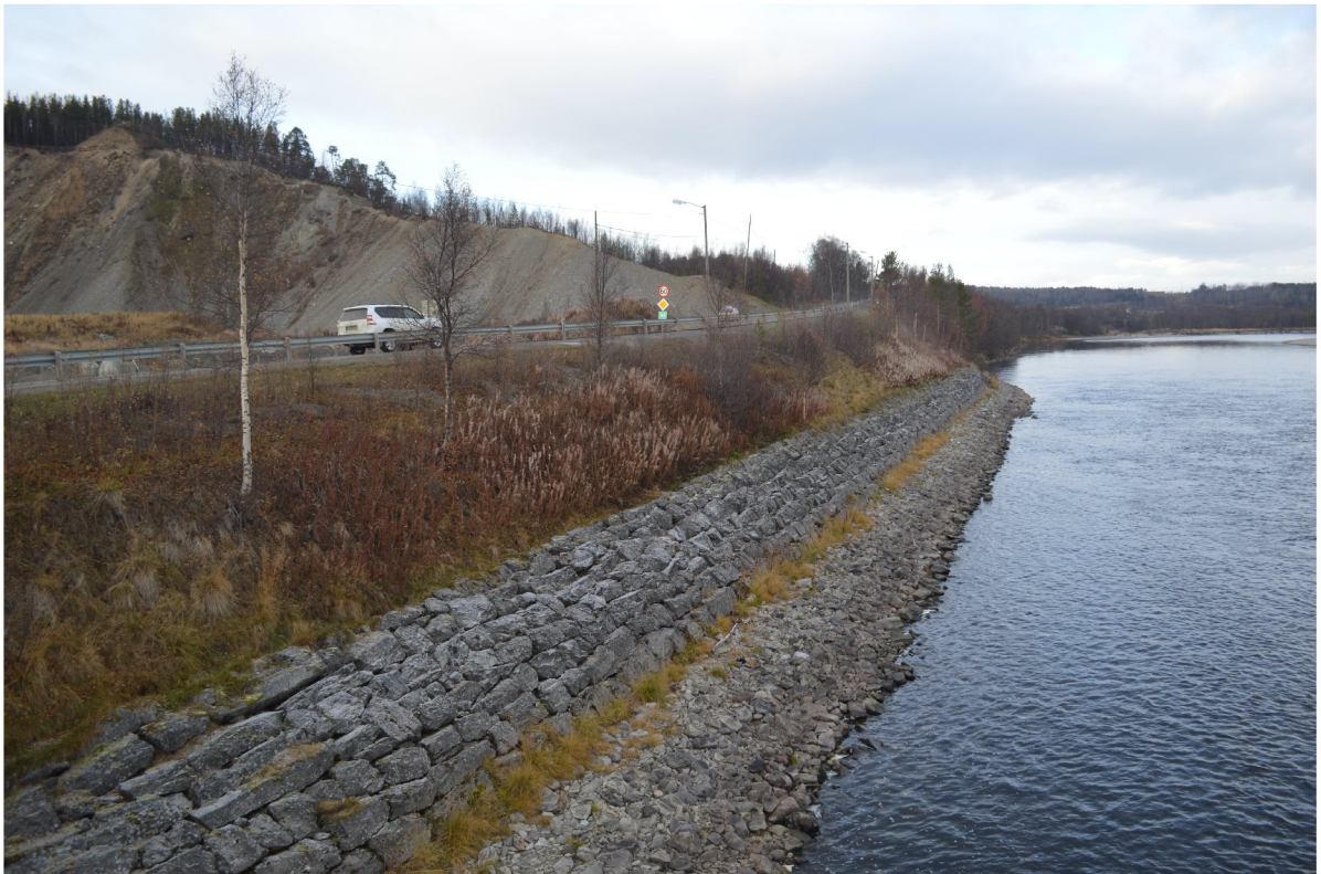
Figur 4: Bilde tatt fra bru mot grustak i nordvest, mur og erosjonssikring mot Altaelva
