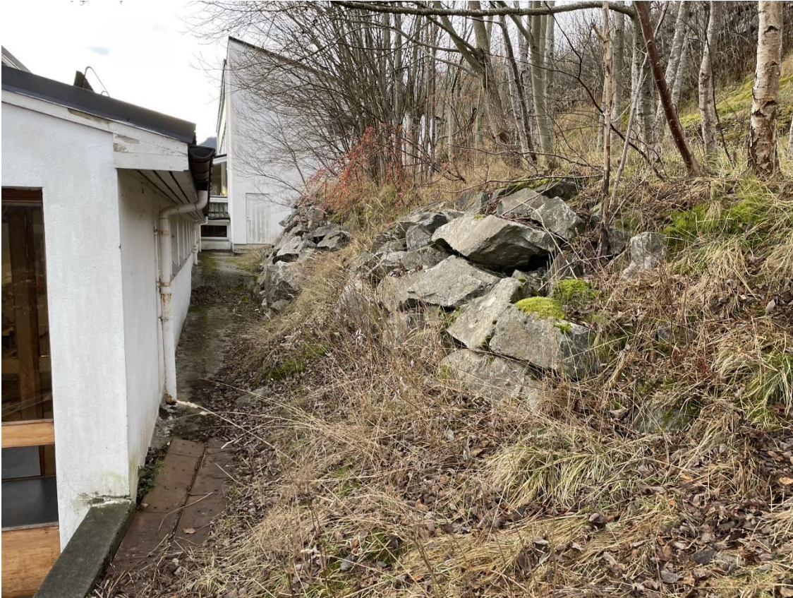
Figur 28. Mulig ustabil mur i terreng ovenfor skolen.
