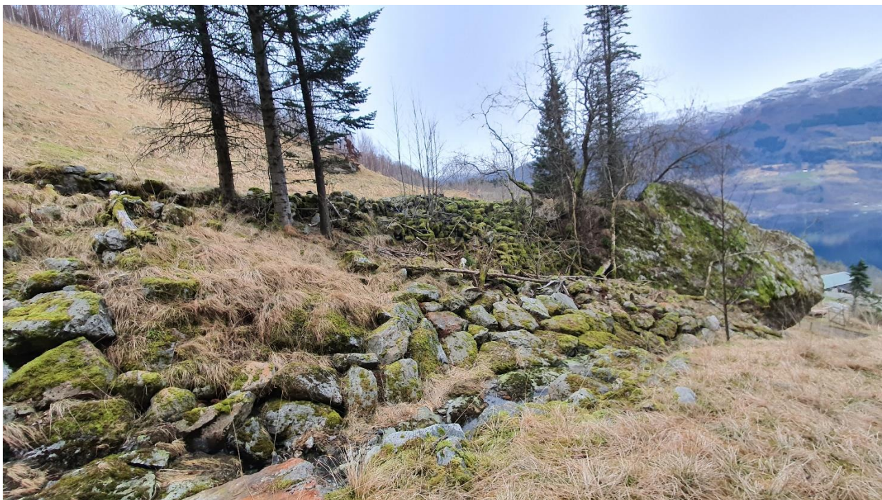
Figur 26: Det er etablert sikringstiltak langs bekkeløpet som kommer ned vest for Rodgo. Bekkeløpet er plastret opp av stein og det er bygd opp en ledevoll med ca. lengde 20 meter i front av en større blokk. Dimensjoneringen av ledevoll tilsier tiltak mot større skred, trolig snøskred, sørpeskred og flomskred.
