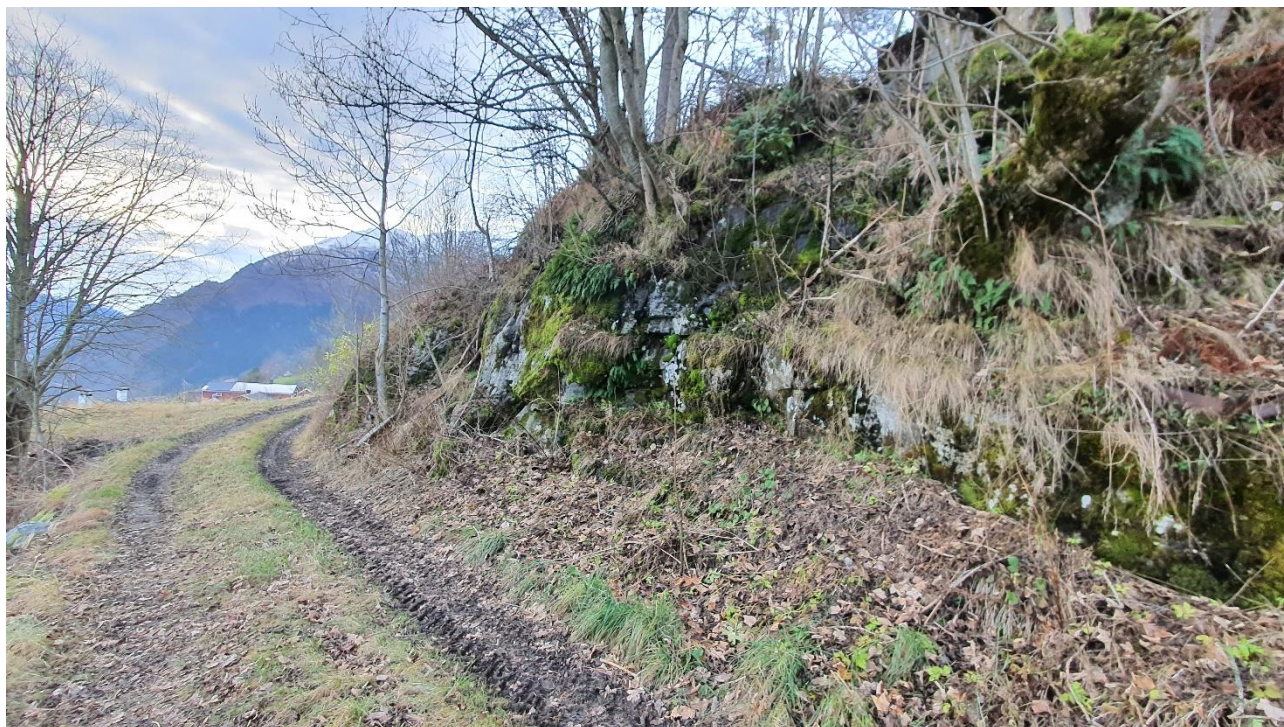
Figur 42: Foto av fjellskrent ved skogsbilveg ved Haugen rundt kote 240.
