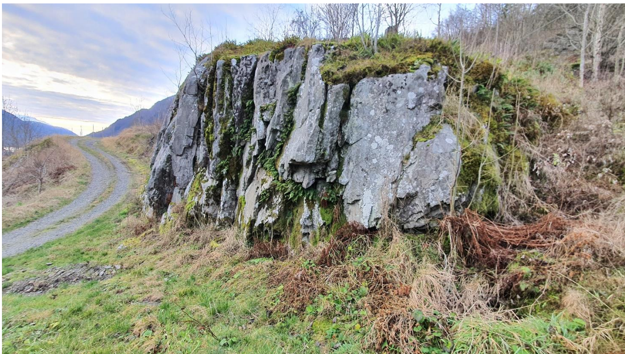
Figur 41: Foto av fjellskrent sørvest for skolen ved Vikebygd. Det kan ikke utelukkes at tidligere utfall har blitt fjernet.
