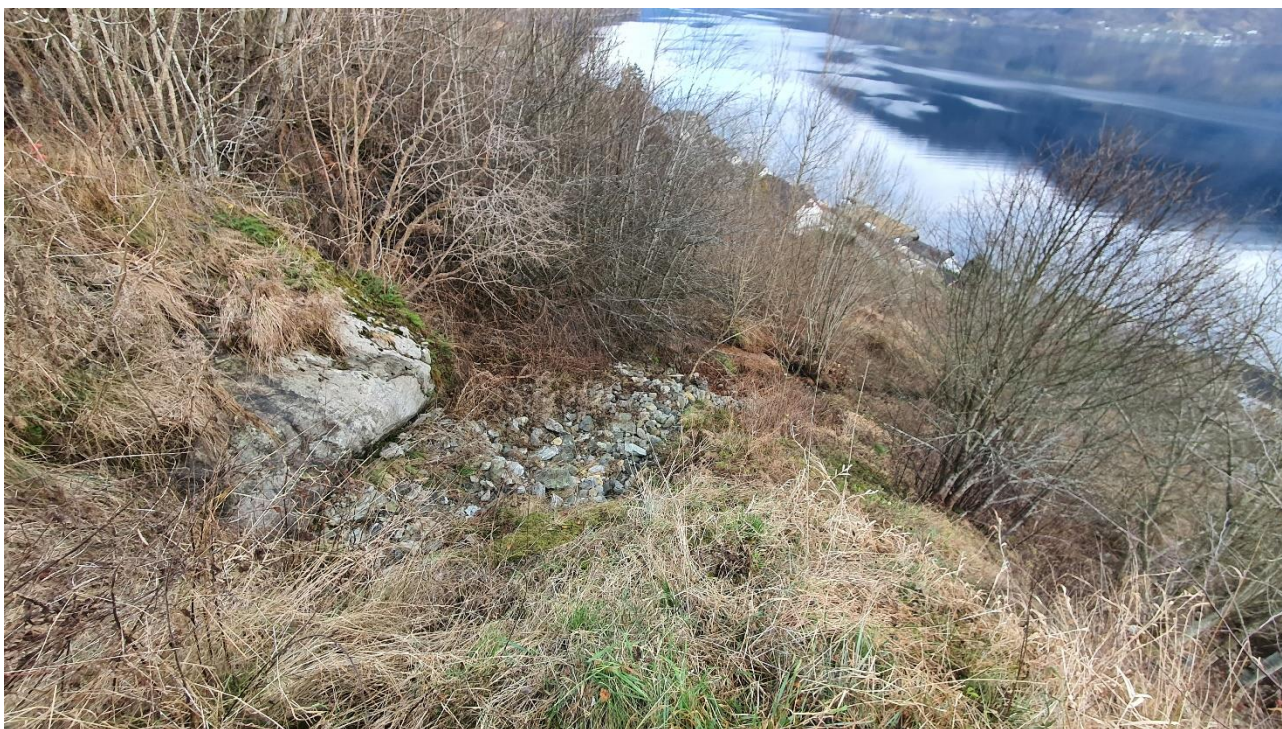
Figur 59: Det er parallelt med avsatte masser spor etter nylig erosjon av vann.
