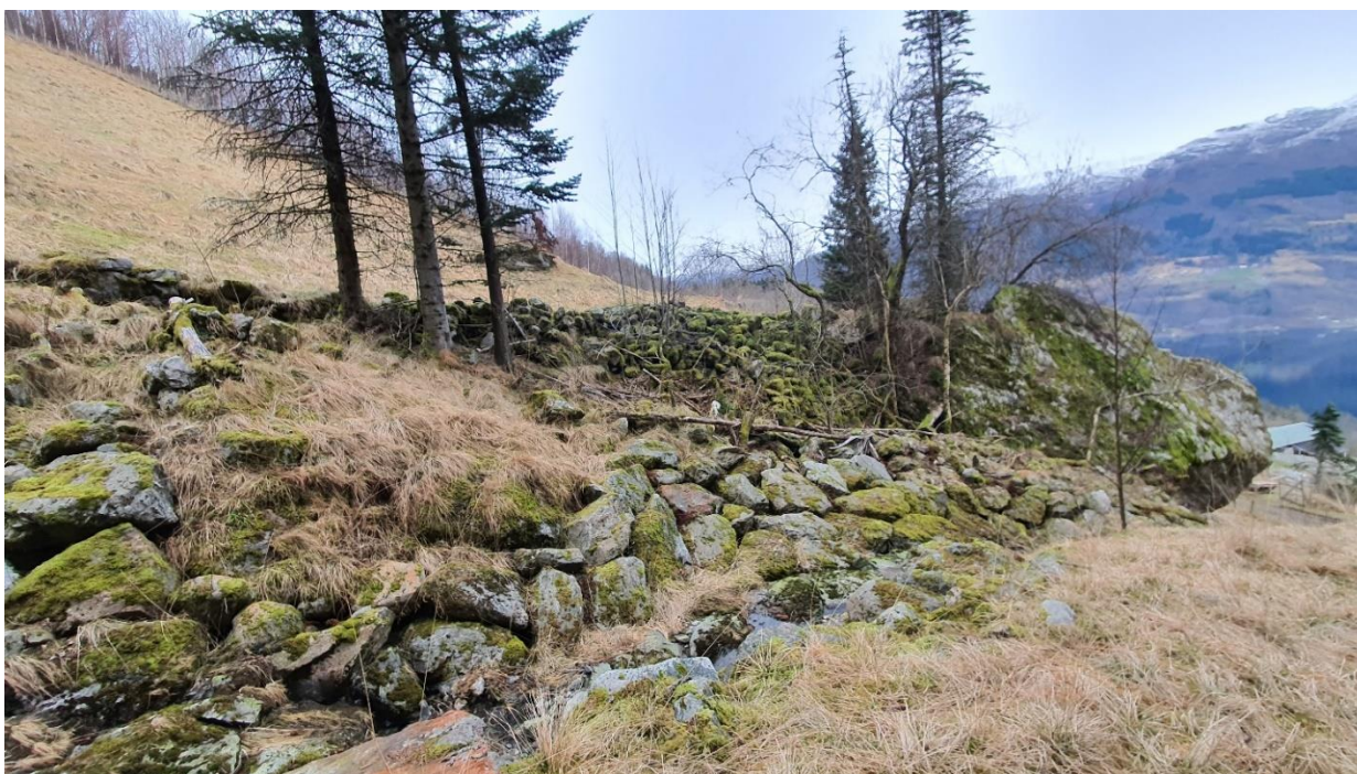
Figur 11: Det er etablert sikringstiltak langs bekkeløpet som kommer ned vest for Rodgo. Bekkeløpet er plastret opp av stein og det er bygd opp en ledevoll med ca. lengde 20 meter i front av en større blokk. Dimensjoneringen av ledevoll tilsier tiltak mot større skred, trolig snøskred, sørpeskred og flomskred.
