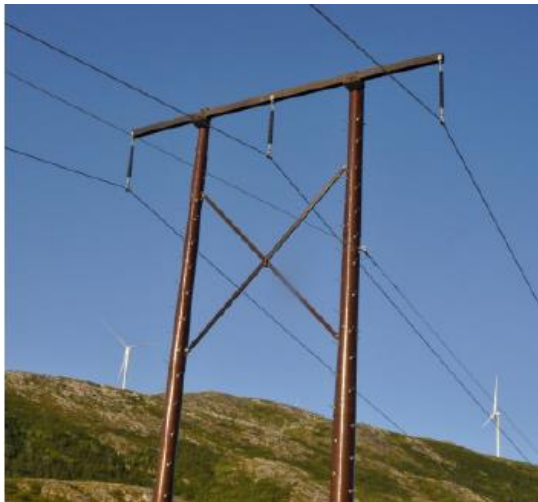
Figur 2-4 Komposittmastene som er etablert på Kvaløya. Gjenskinn i mastene er påfallende ved solskinn. Den mørke fargen kunne vært noe dempet for å redusere kontrasten mot bakgrunnen.
