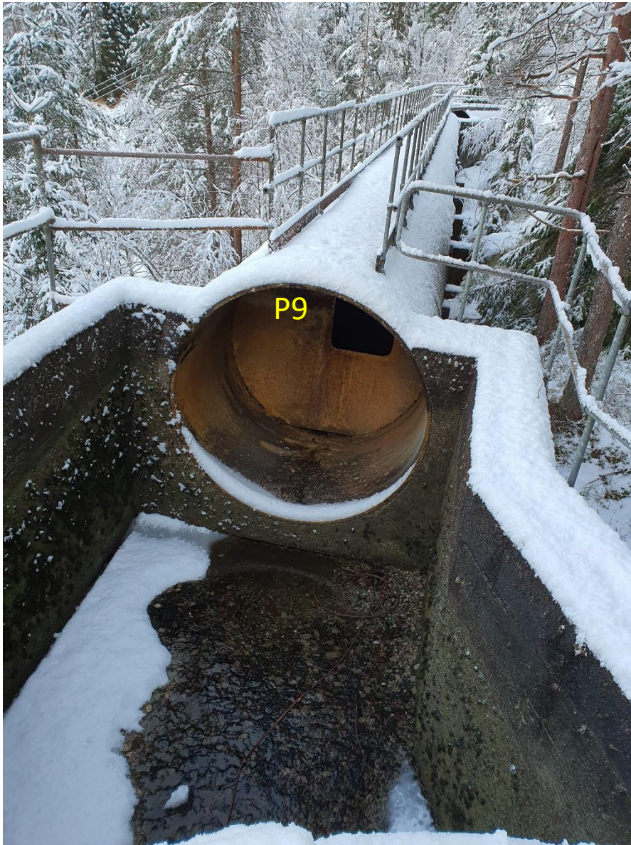
Figur 10. Uthoppet fra nest øverste rørseksjon. Alle rørseksjoner har både innhopp og uthopp i åpne betongkuler, noe som bidrar til både lystilgang og hvilekuler med større vannvolum og lavere grad av turbulens (foto: M. Kraabøl).
