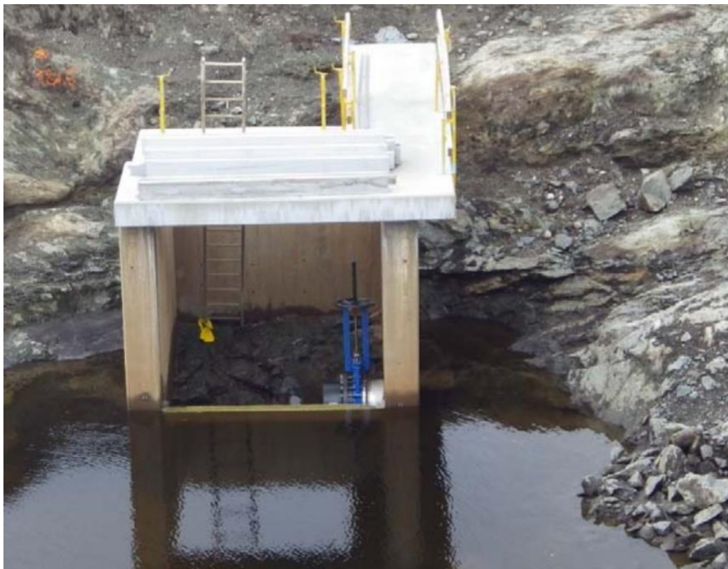
Bilde 3: Nærbildet av inntaket med tappeventil.
