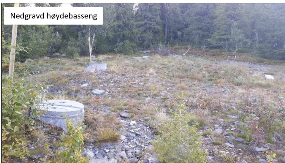
Figur 7. Høydebasseng bestående av to nedgravde glassfibertanker. Totalt volum er 40 m 3 .
