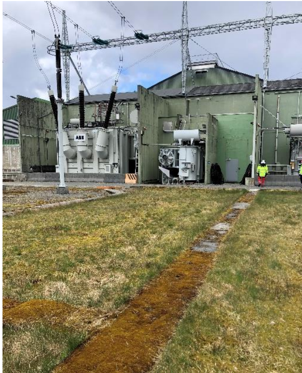
Figur 7 Kabelkanal fra kontrollhuset og gjennom transformersjakt T9.
