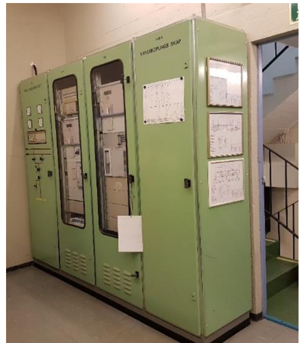
Figur 10 Kontrollanleggsskap Børtveitfeltet. Fjerning av dette er en del av prosjektomfanget.
