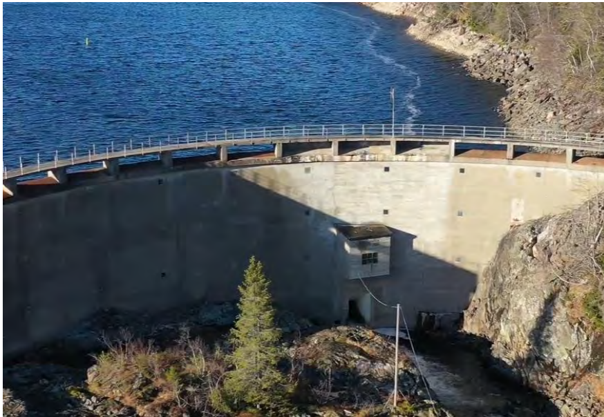
Figur 39. Slipp av minstevann fra dam Borsæ foregår via dykket luke. Graden av dykking avhenger i stor grad av magasinfyllingen.
