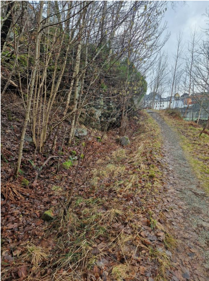
Bilde 3. Skråning i sørøst med små bergpartier og fare for remobilisering. Observert nedfall i grøft. Sett mot sør.
