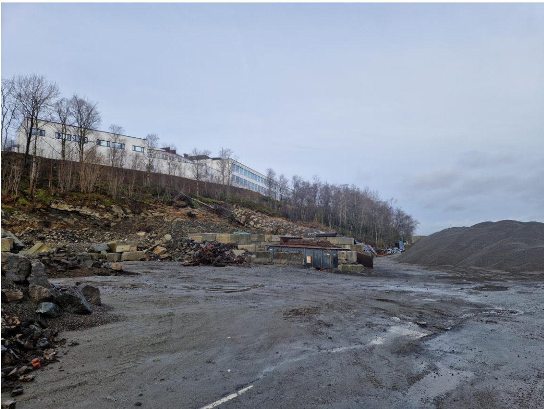
Bilde 10. Avgravn skråning med tynt vegetasjonsdekke. Sett mot nordvest.
