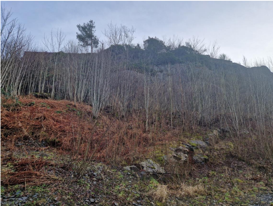
Bilde 5. Slakere parti med bergskrent i øvre del. Fare for remobilisering av blokker og små utglidninger av vegetasjonsdekket uten skadepotesial. Sett mot øst.
