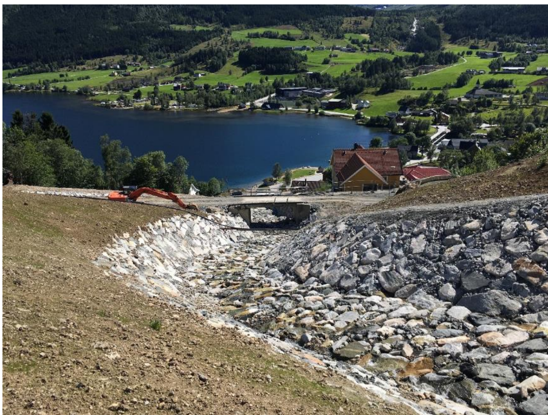
Figur 5 Brua med brukar står igjen. Her ser vi en innsnevring mellom kanal og bru som kan presse vann og masse til høyre opp på veg.
