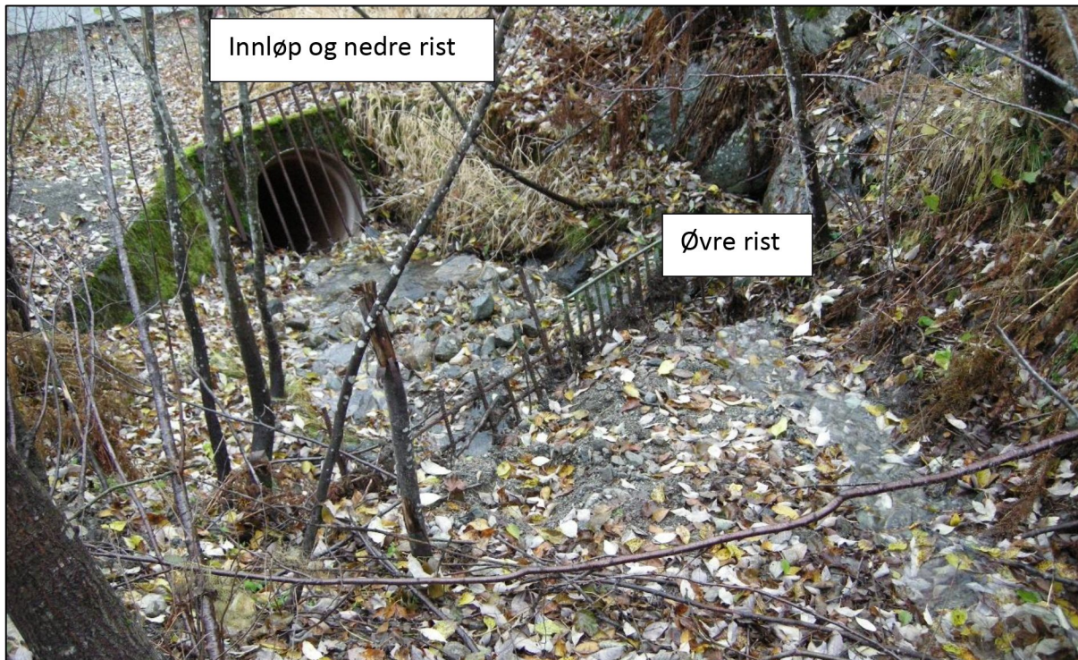
Figur 6: Kulvertinnløp ved Remen ovenfor veien Bergshagen. Oppstrøms av øvre rist er det avsatt 80 cm løsmasse, noe som ikke kommer tydelig frem på bildet.
