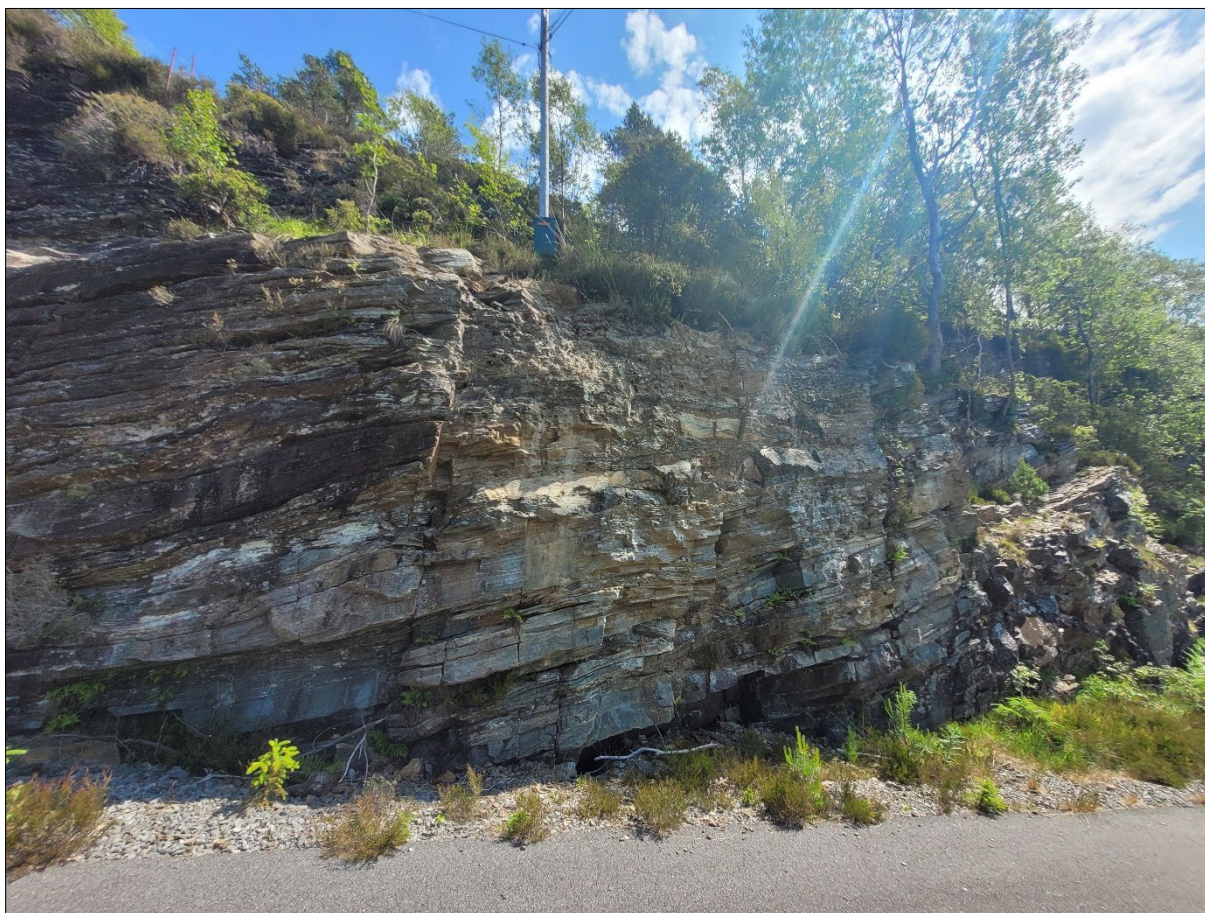
Figur 8: Bilete av fjellskrent ved infopunkt 7 som viser mot aust. Foliasjonsplana fell slakt mot nordaust, og det er sprekkplan som føl overflata til fjellskrenten, og normalt på denne. Her ser ein òg ei overgangssone frå naturleg fjelloverflate til venstre og overflate påverka av sprenging til høgre.
