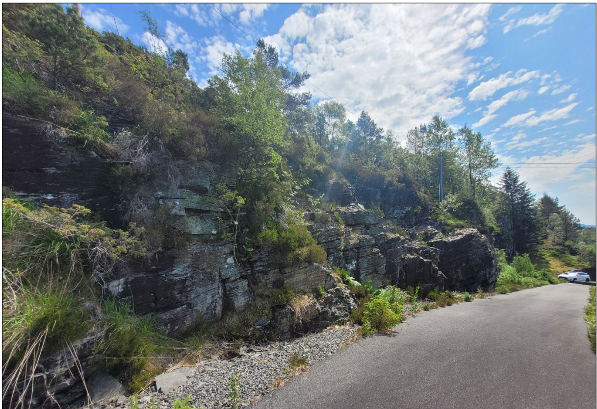
Figur 19: Fjellskrent er høgare herifrå og sørover, og har potensiale for utfall av stein og små blokker. Infopunkt 6.
