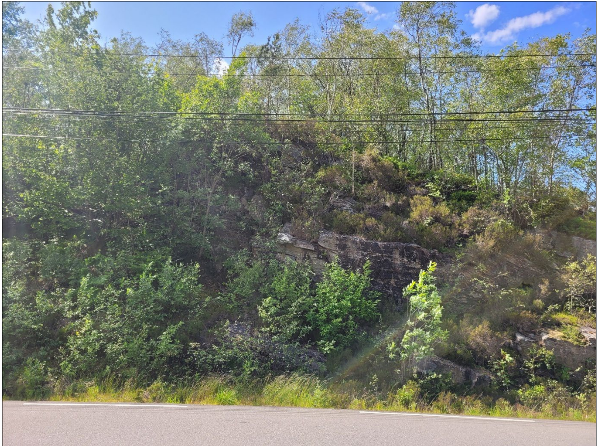
Figur 22: Fjellskrent langs Kollevågvegen, ved vestre grense til Kollevågvegen. Enkelte ustabile parti er observert, og losnesannsyn er vurdert som mellom 1/100 og 1/1000 per år. Ingen spor etter ferske blokker. Infopunkt 12.
