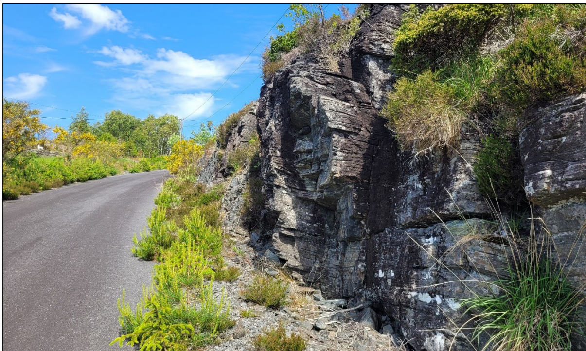
Figur 17: I grøfta langs den nye tilkomstvegen ligg det mykje materiale som stammar frå vegbygginga, men òg stein og blokker som er tolka som ferske utfall frå skjeringa/skrenten.
