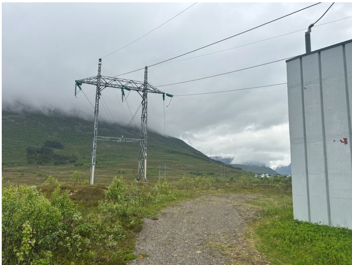
Figur 6 Eksisterende endemast og muffehus på Hinnøya skal rives til fordel for nye omsøkt kabelendemaster.
