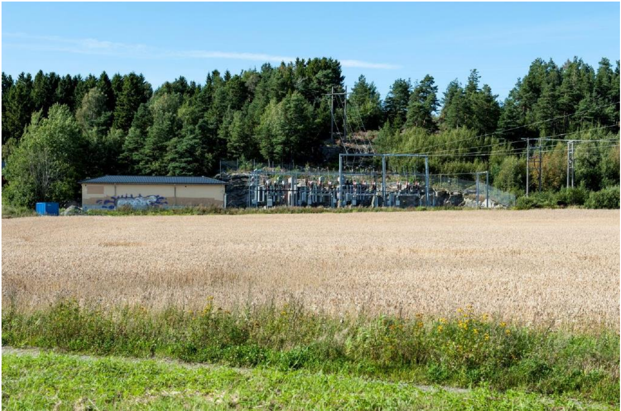
Figur 5-5. Dagens transformatorstasjon ved Fjærå.
