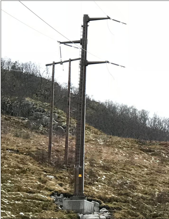
Figur 90 Eksempel på stålmast fra et annet prosjekt. Masteutforming benyttes som vinkelmast og forankringsmast. Foto Linea AS
