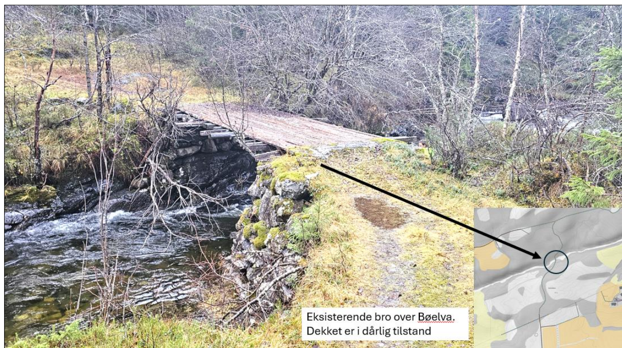
Figur 148 Eksisterende bro over Bøelva ved en skogsvei er i dårlig forfatning. Denne må oppgraderes dersom den skal anvendes trygt.
