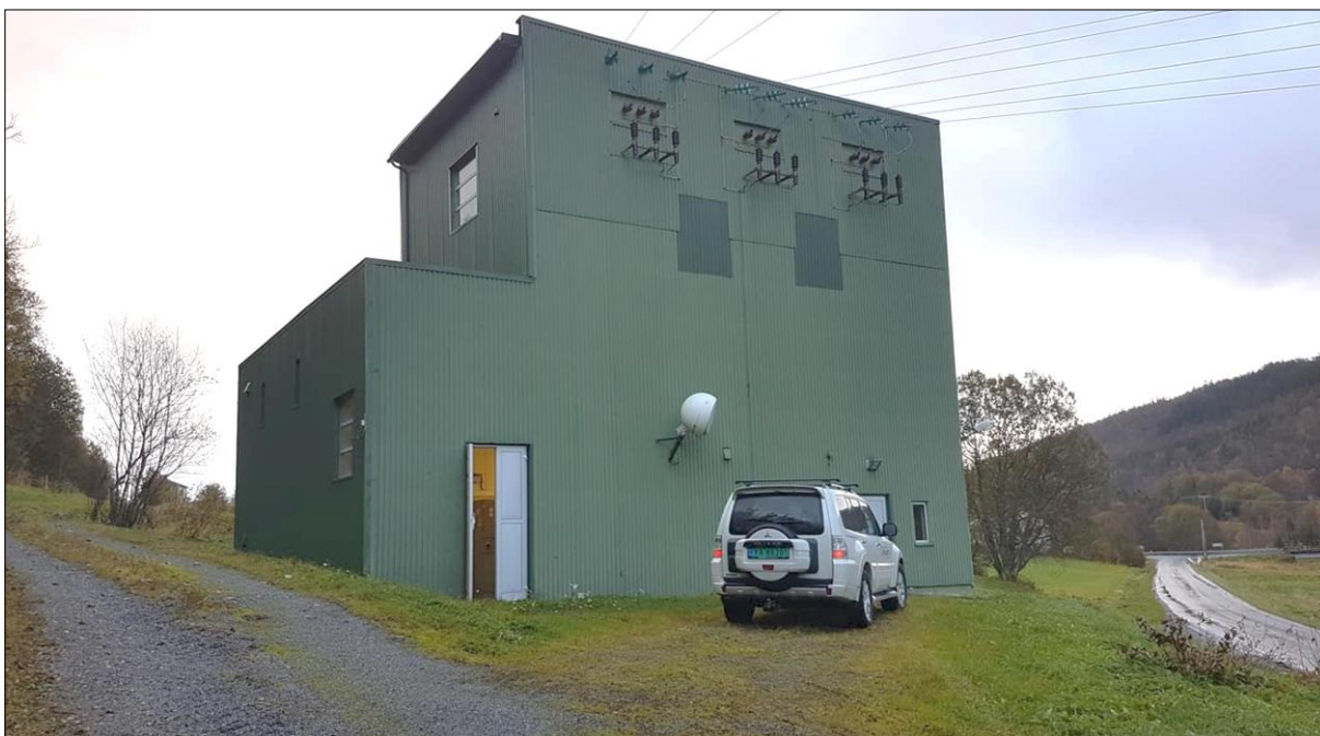
Figur 221 Eksisterende Meisfjord Transformatorstasjon. Foto Linea
