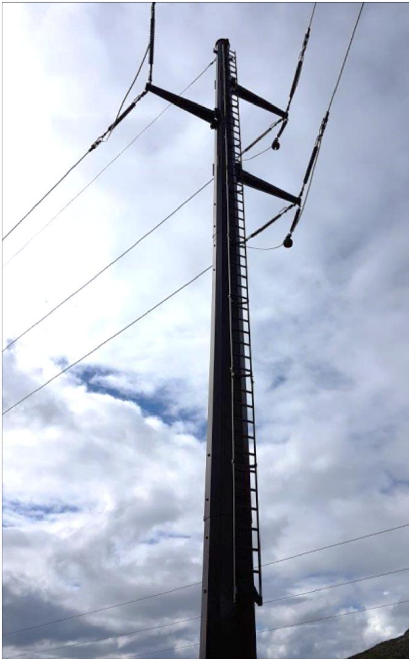
Figur 92 Eksempelbilde stålmaster i vinkel fra ett annet prosjekt. Bilde Rejlers
