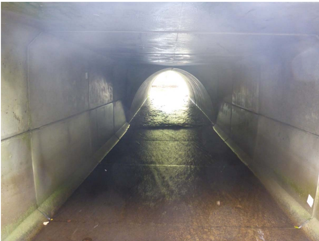
Figur 16: Kulvert sett medstrøms. En markert knekk der ny kulvert møter gammel
