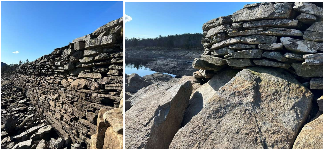
Figur 6: Skader på dam/mur 1. Skade fra istrykk og manglende fundament.
