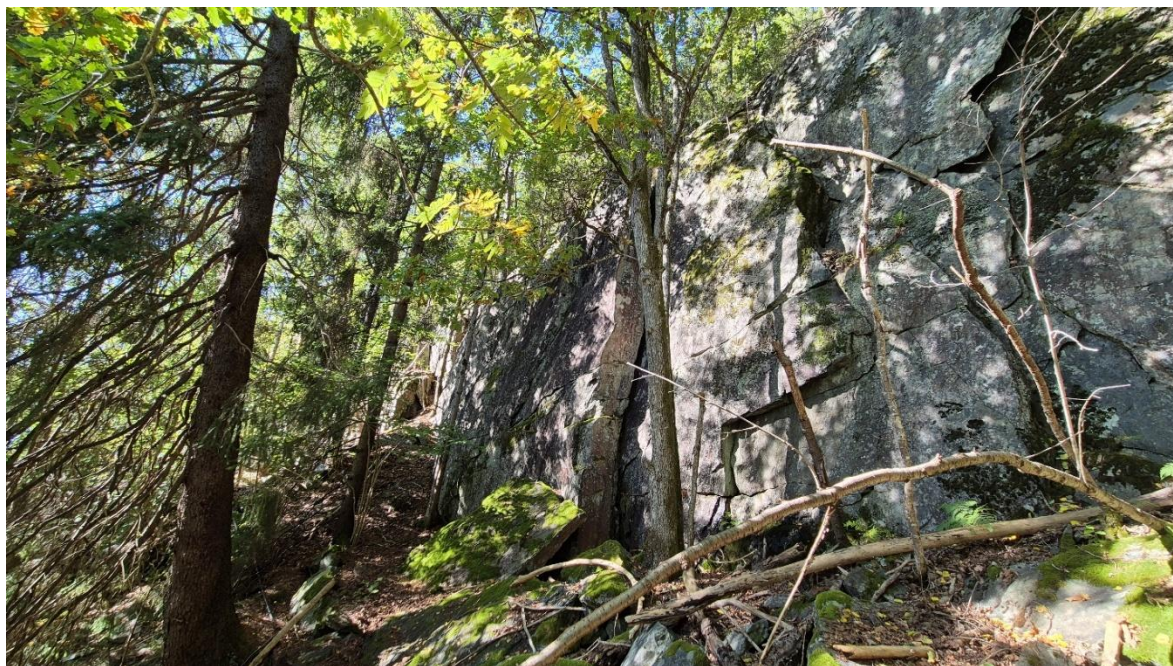
Figur 3: Flakdannelse observert langs foliasjon. Spor etter nylig utfall. Steinsprangur ned til elven. Foto fra infopunkt 22.
