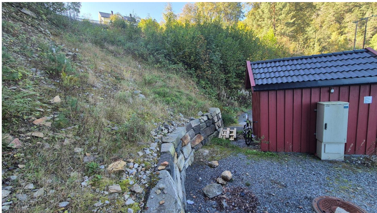
Figur 5: Spor etter nylig utfall fra infopunkt 34. Blokker tilsvarende små volum vil forekomme med løsnestannsynlighet større enn 1/100, men vurderes å ha lite skadepotensial.
