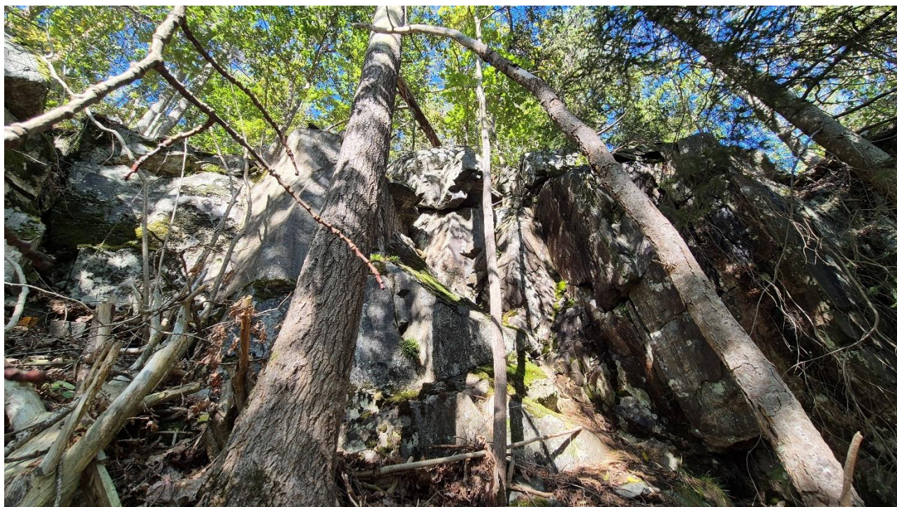
Figur 20: Mulig løs blokk på toppen av skjæring (1-2 m 3 ). Løsnestannsynlighet vurderes så være større enn 1/100 for aktuell blokk i toppen grunnet usikkerheten, men resterende skrent vurderes å ha løsnestannsynlighet mindre enn 1/100, men større enn 1/1000. Det er observert gjennomgående oppsprekning langs foliasjon. Foto fra infopunkt 18.
