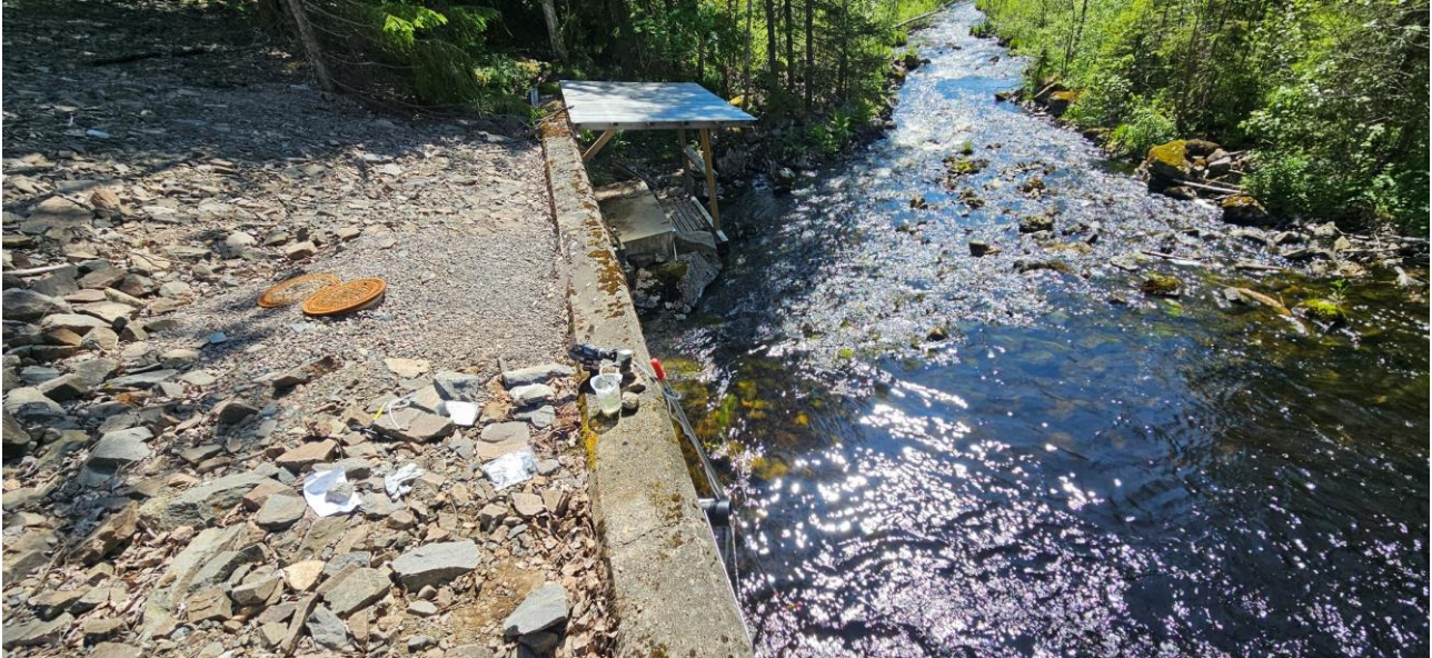
Figur 2-4. Stasjon for pumping av vann fra Byvann nedstrøms dam ved utløp av bunnluke. Foto: Multiconsult ASA.
