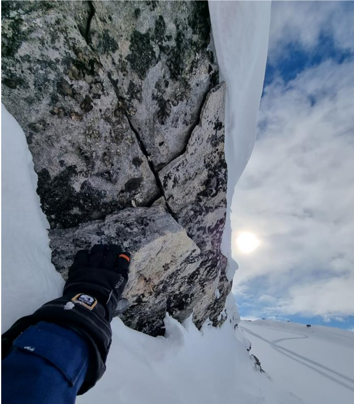
Figur 4.1-4: Bilde tatt mot sør av en svakt overhengende skrent/løsnemråde Stein6, som består av oppsprukken gneis. Infopunkt 8 i registreringskart. Foto: GeoRisiko AS, 2024-03-24.
