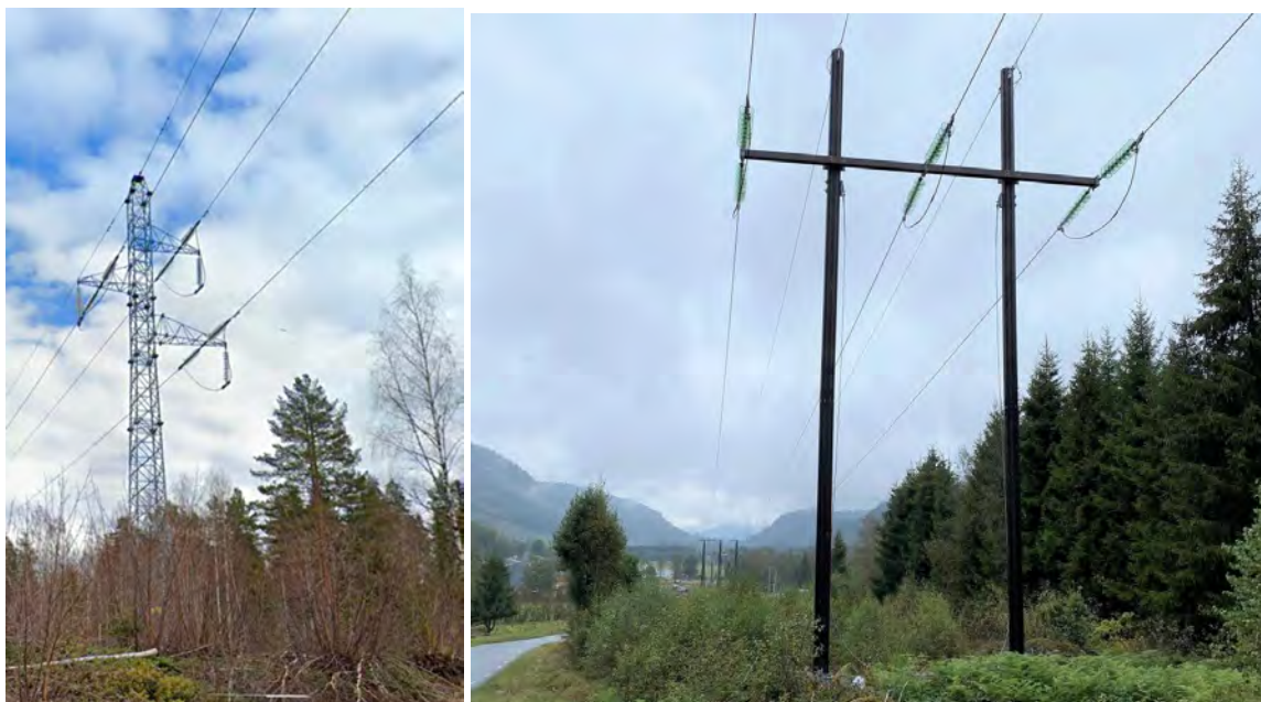
Figur 9. Mast på 132 kV kraftledningen Hjartdøla – Rød (venstre) og mulig endemast mot ny stasjon (høyre)
