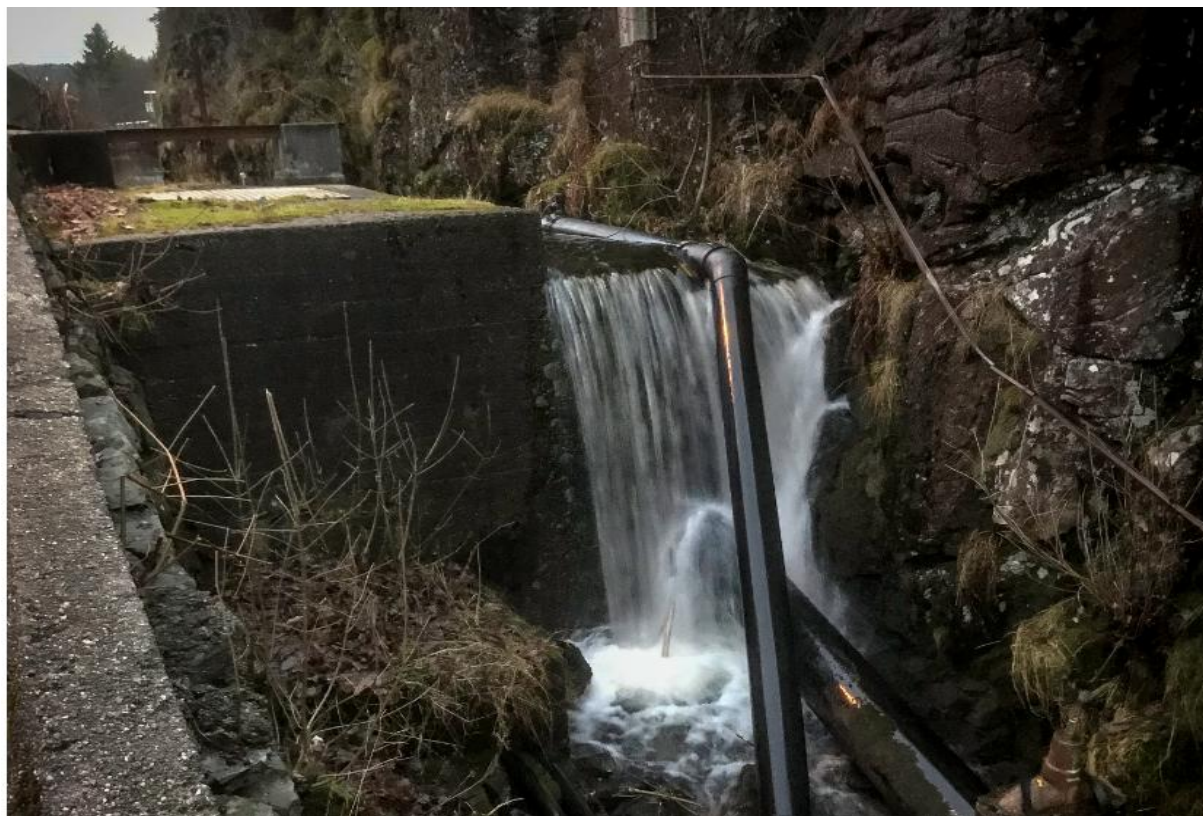
Dammen i utløpet av Storavatnet er vel 2 m høy. De to inntaksledningene til anlegget i Tveitevågen er på 400 mm gjennom dammen og 250 mm over dammen. Det lekker anslagsvis 1-2 l/s gjennom dammen.
