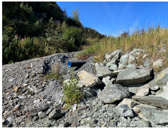
Figur 10 Ukjent rør ut av fylling. Informert de som håndterer overvann og byggherre.
