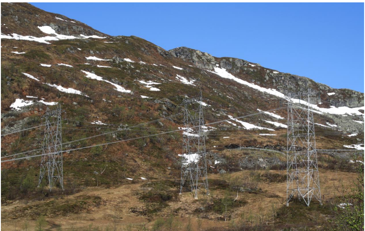
Figur 3-38. 132 kV master (Fortun- Øvre Årdal). Aluminiummasten til høyre er mer fremtredende i landskapet enn de to stålmastene til venstre. Stålmastene med mer matt overflate og en nyanse som er mer ton i ton med et typisk naturlandskap vil gli inn bedre inn i omgivelsene. Foto: Statnett.
