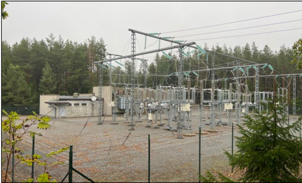
Figur 8 Dolven transformatorstasjon (Kilde: Aneo AS)
