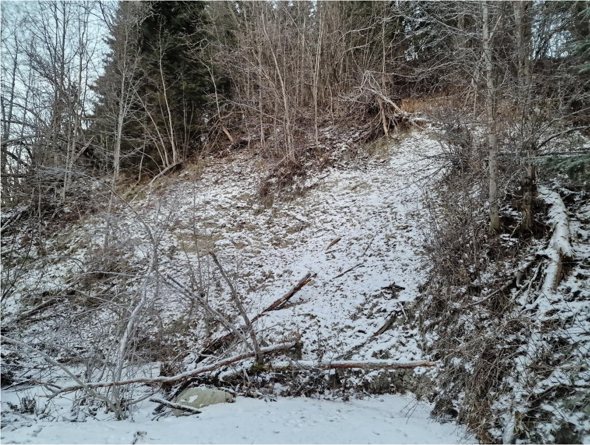
Figur 4-10 Bilde 133253, erosjon og overflateutglidning langs bekkeløp (score 2).
