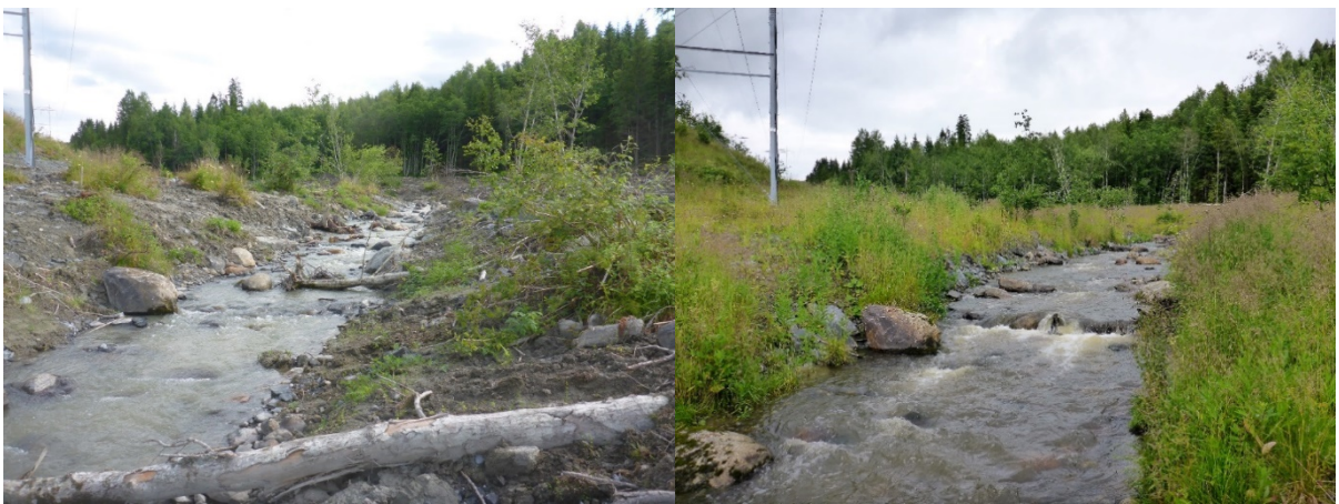
Bilde 6: Hofstadelva samme sted etter endt sikringsarbeid. Bildene er tatt henholdsvis i 2015 og 2017
