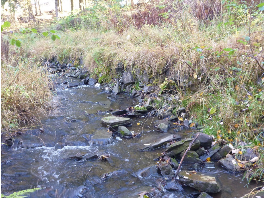
Bilde 13: Skader på eksisterende sikringstiltak nedstrøms skolen (sett motstrøms).
