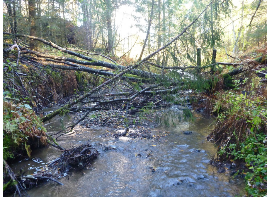
Bilde 14: Erosjon i bekkesiden i øvre del (sett motstrøms). Sikring anbefalt.
