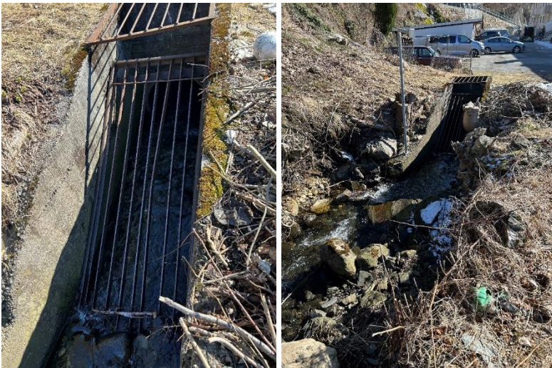
Figur 6-3. Inntaksrist foran inntak til Ø800 mm overvannsrør som Øyrabekken renner inn i. Bilde: Norconsult
