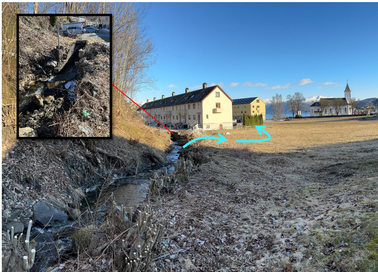
Figur 5-2. Bilde fra befaring av Øyrabekken ved innløpet til overvannsrøret. Bildet viser hvor Øyrabekken går inn i rør som danner et kritisk punkt som fører til at bekken renner ut på høyre bredde (sør) og ut over Mikkjelsflaten. Bilde: Norconsult
