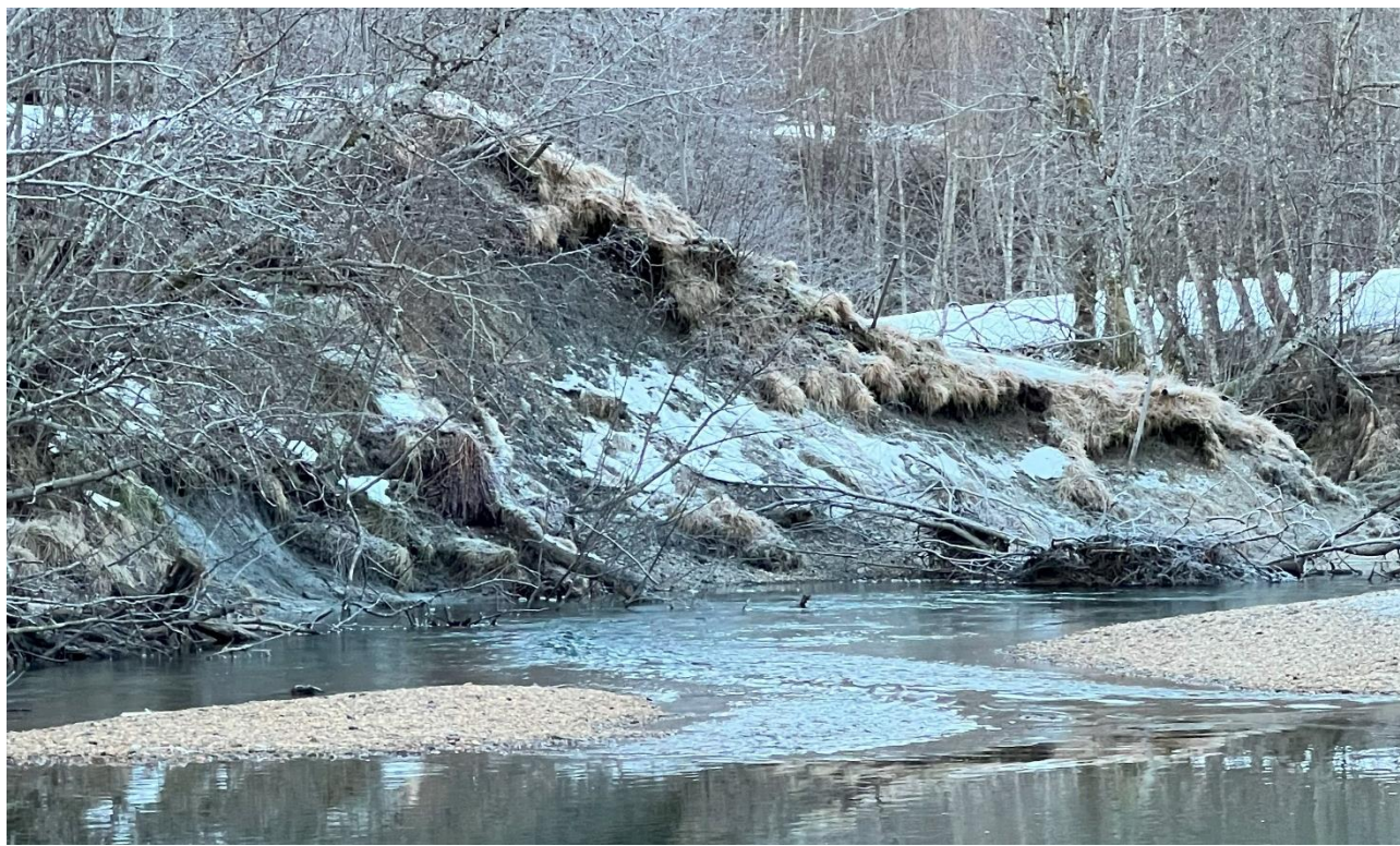
Figur 2-7: Bilde viser pågående erosjon i skråning opp fra elva. Bildet er tatt mot nord.
