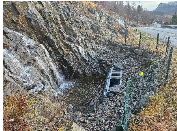
Inntaket til OK02.
