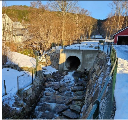
Utløp GT04 fra innløp GT01. Flømløp fra utløp GT03 er synlig til venstre for kulvertutløpet.
