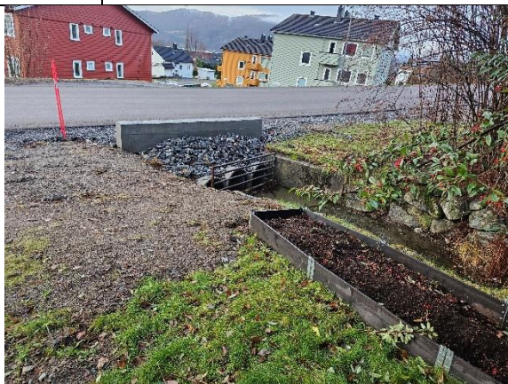
Innløpet til OT02.
