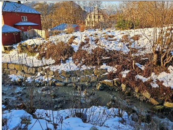
GS01 der erosjonssikringa/tørrmuren har glidd ut.
