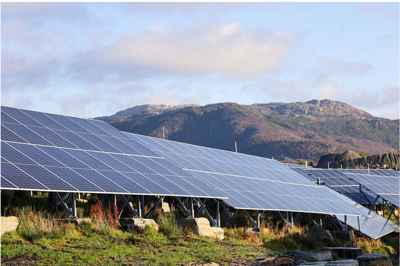
Figur 18: Naturstein benyttes som ballast for festesystemet. Bilde er mottatt fra SJSol.
