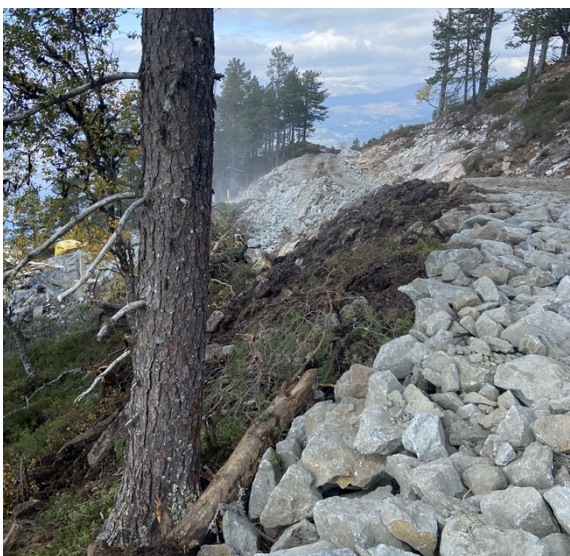
Bilde 7: Uheldig bruk av toppmasser. Foto: NVE.
