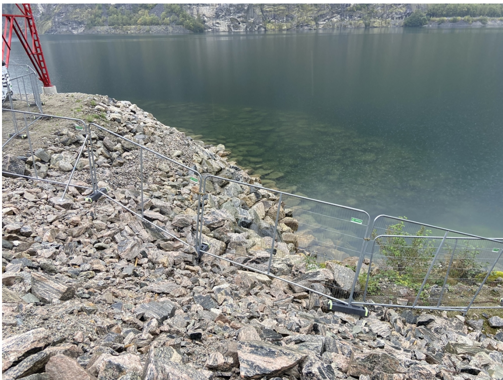
Bilde 16: Vi så småstein i plastringen for endemasta utenfor anleggsgjerdet. Dette bør fjernes. Foto: NVE.
