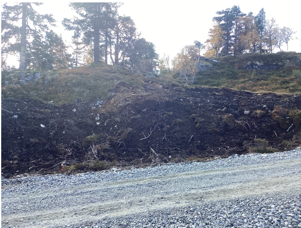
Bilde 1: Eksempel på sidetak langs R9, og som ikke er i tråd med godkjent detaljplan. Foto: NVE.
