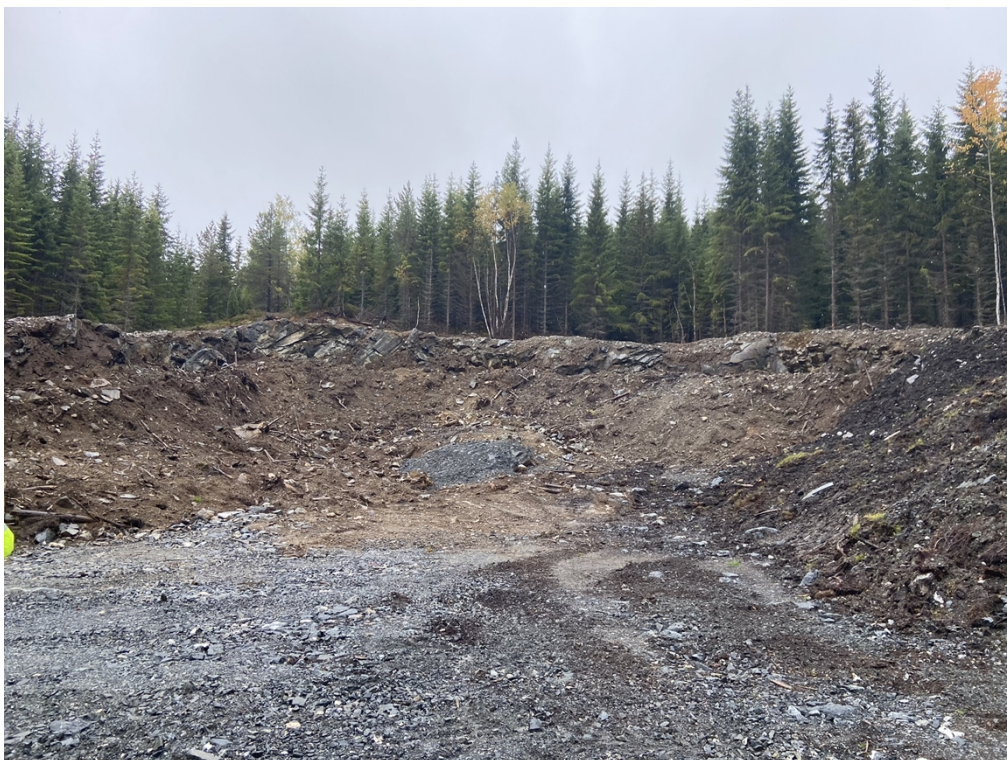
Bilde 21: Massetak som NVE mener ikke er lukket på en god nok måte. Foto: NVE.
