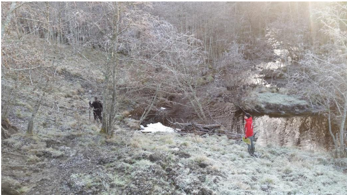
Figur 1: Større utglidning i oppstrøms ende av tiltaksområdet som må stabiliseres.
