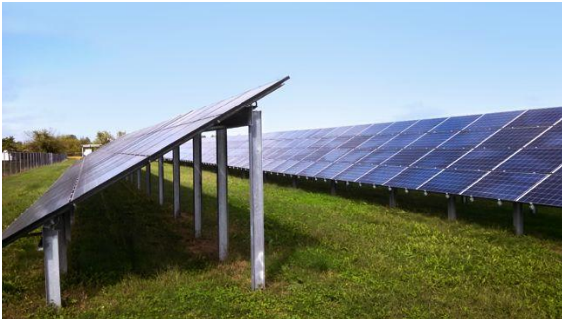
Figur 3-3: Eksempel på fast-vinkel installasjonsløsning (foto: Willowbrook Solar)
