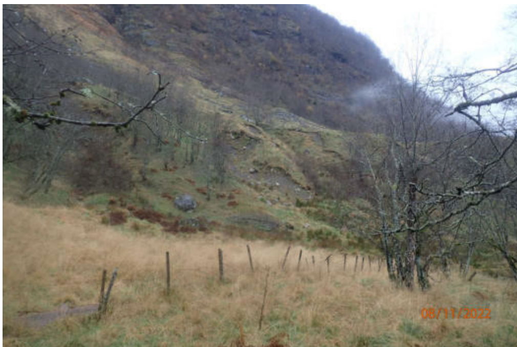
Bilde 2, erosjon i moreneavsetningene ned mot kraftstasjonsområdet
