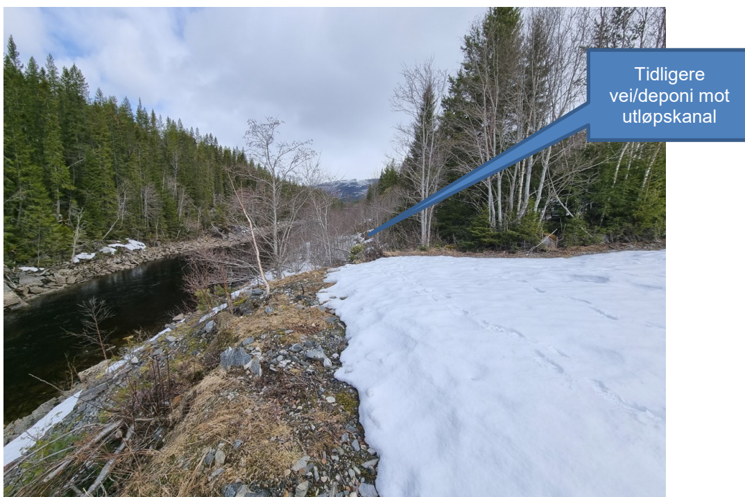
Figur 8: Der alternativ skogsveg kommer ned til elva. Her er nivået fra den opprinnelige tippet som ble bygd, men veien langs tippet mot utløpet krever en del istandsettelse og utfylling.
