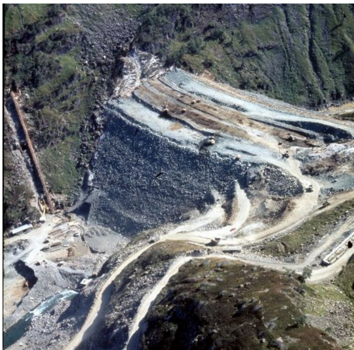
Billete av demningen som har øydelagt tilkomst til nasjonalparken /Hardangervidda vest gjennom Valdalen
