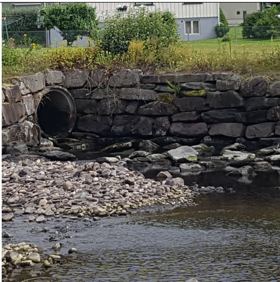
Bilde fra driftstans, omløpsventilen er ute av drift. Foto: Tore Solbakken - GSFF
