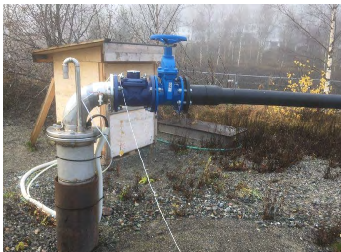
Figur 2 Bilde av tett brønntopp/brønnhodesikring med lufting høyere enn brønntopp.
