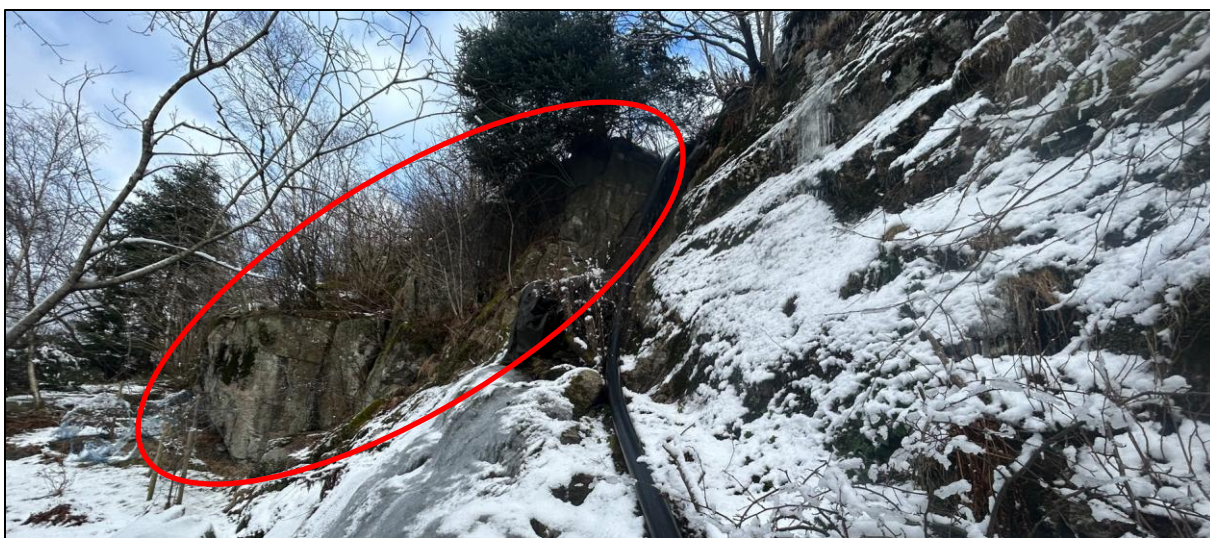
Figur 7: Tversnitt av blokkpartiet i nordleg/midtre del av skråninga (markert med raudt omriss, infopunkt 1) viser at berggrunnen sprekk opp langs foliasjon, i tillegg langs enkelte sprekker orientert nord-sør, med fall på ca. 80 grader mot vest. I sørleg del sprekk berggrunnen opp langs fjelloverflata (til høgre i bilete, infopunkt 2).
