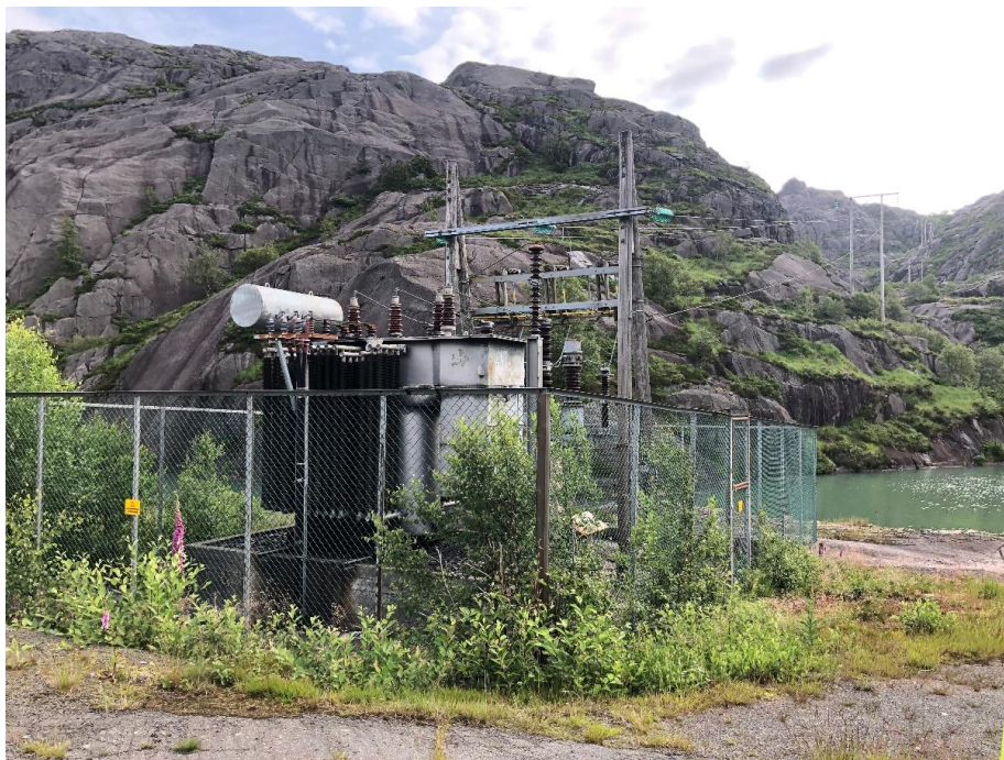
Figur 4: Dagens transformatorstasjon ved Tørkeanlegget
