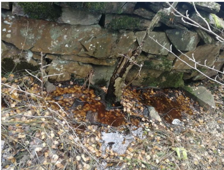
Figur 2: Bildet syner utlekking av vatn fra dam Måstادتjern (foto: Malén Kårstad, 08.11.2021).
