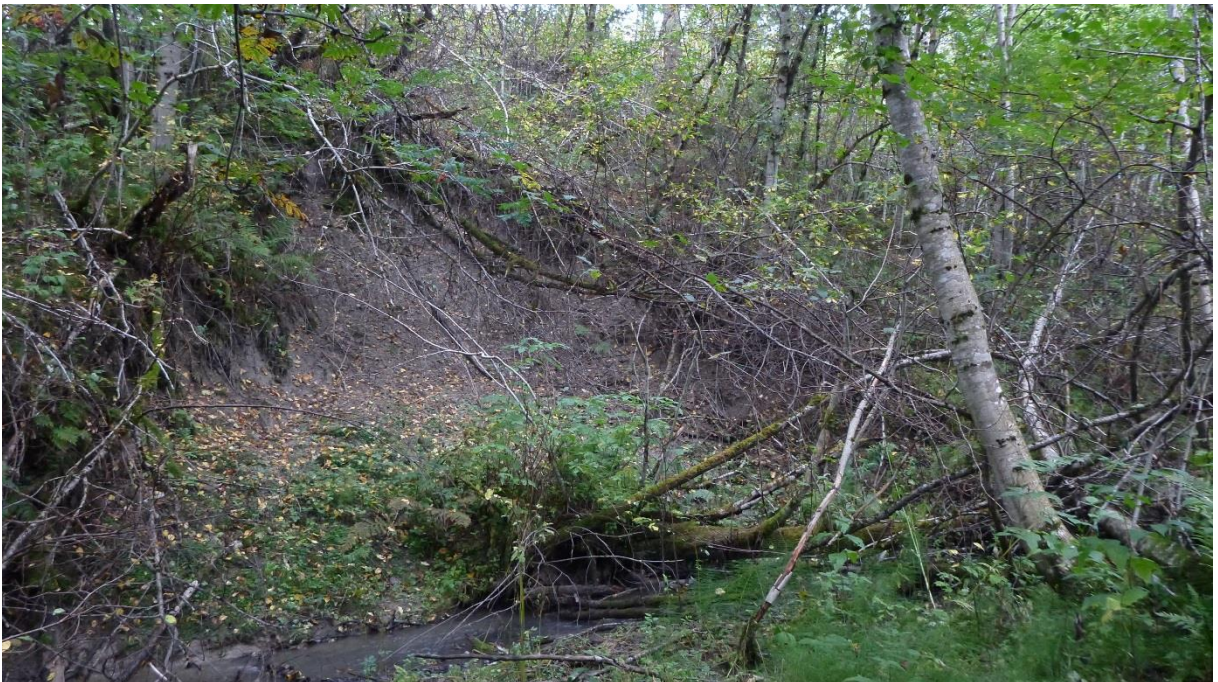
Figur 5: Erosjon og utglidninger i yttersving av Leirfallbekken.
